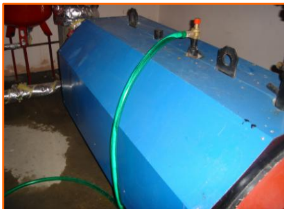
í »Õ³ Ì³ Ì³ Ì³ Ì³ çñ³ Ì³ ù³ óáóÇá Ì³ Æ³³ Water heating boiler installed
